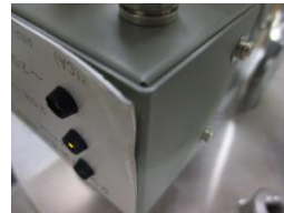
ポンプ温度計に変形有り
